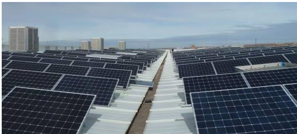
Imagen de las placas fotovoltaicas instaladas en la fábrica de Drylock Technologies
